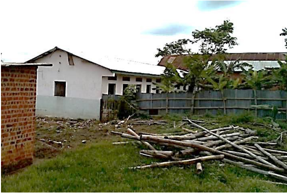
KUIMBA ITM Volledig nieuw dak op internaatgebouw voor meisjes van het Institut Technique Médical
